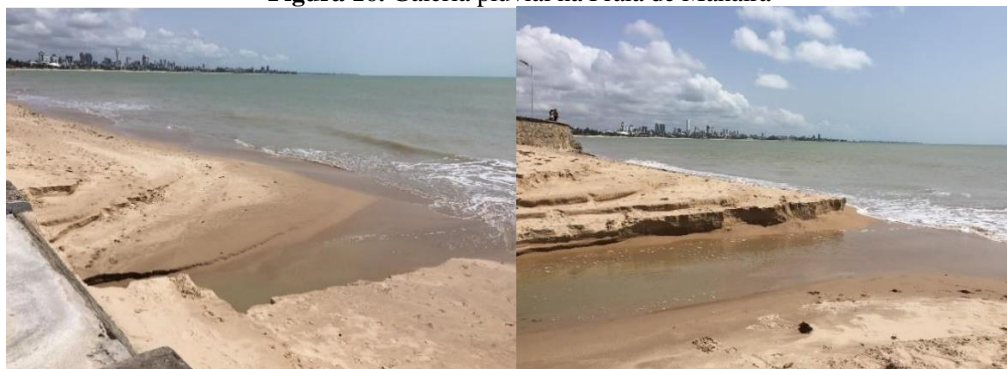
Figura 16. Galeria pluvial na Praia de Manaíra
