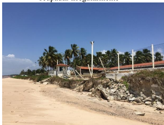
Figura 45. Desmoronamento de áreas ocupadas irregularmente
