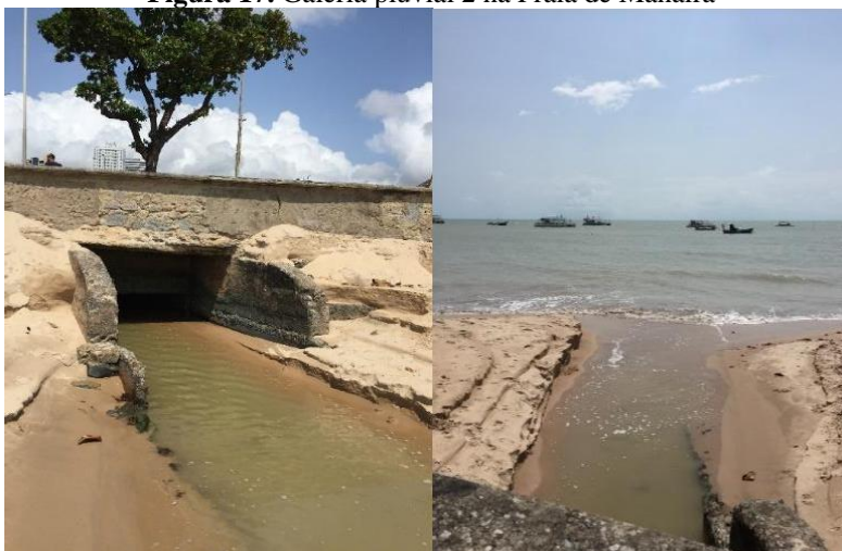
Figura 17. Galeria pluvial 2 na Praia de Manaíra
