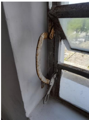
Figura 3 – Janelas basculantes da sala CT-M 201 com ferrugem
