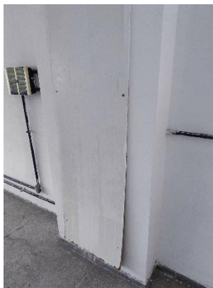
Figura 1 – Problemas no shaft da sala CT-K 201
