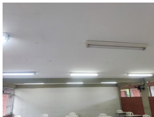
CTE 101: buracos no forro de gesso
