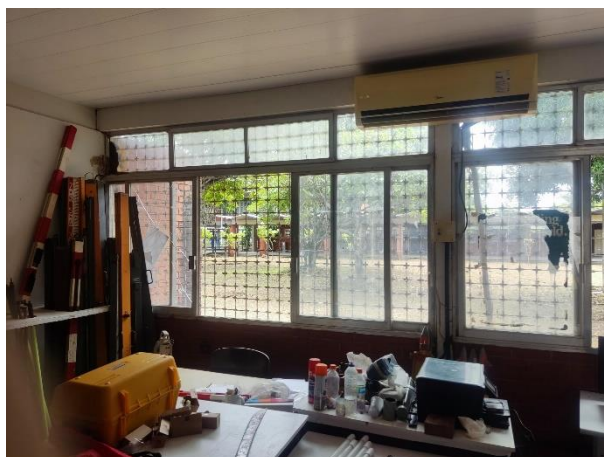
Figura 4 – Vidro quebrado na janela do Laboratório de Topografia
