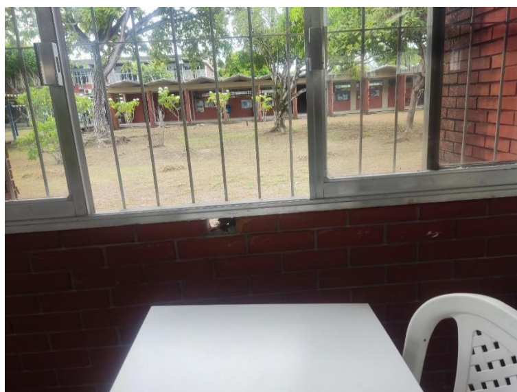
Figura 1 – Problemas das paredes das salas do Bloco CTE (na foto CTE 101)
