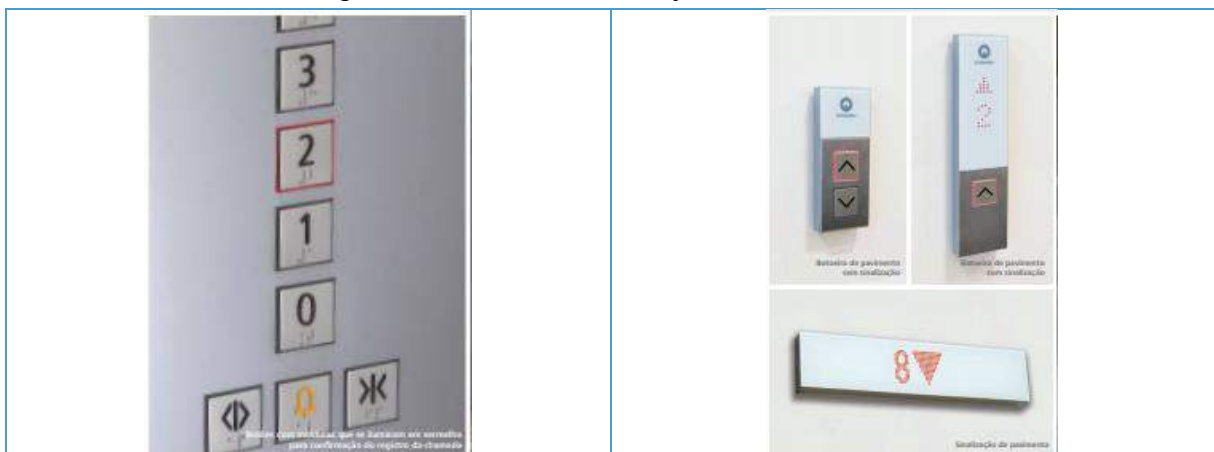
Figura 64 - Botoeiras internas a cabine Figura 65 - Botoeiras e identificação externa de andar
