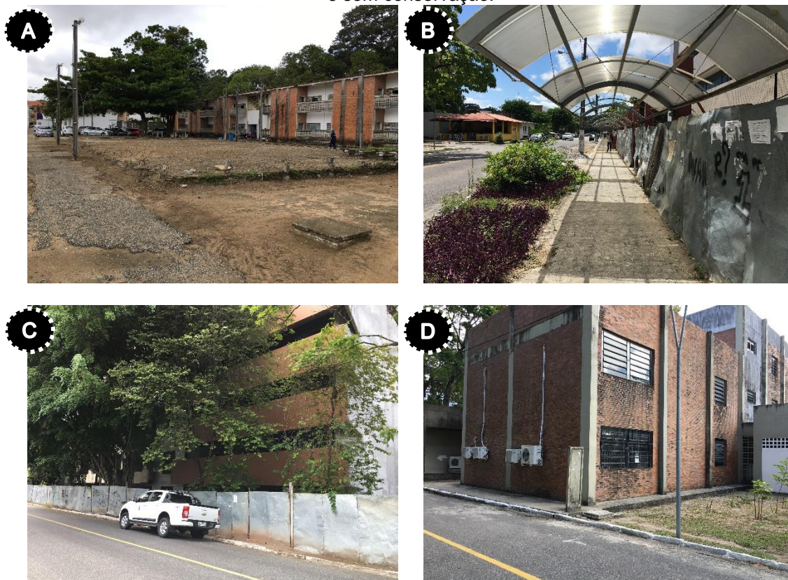
Figura 28: Estruturas de passarelas cobertas e pavimentação de calçadas danificadas, interrompidas e sem conservação.
