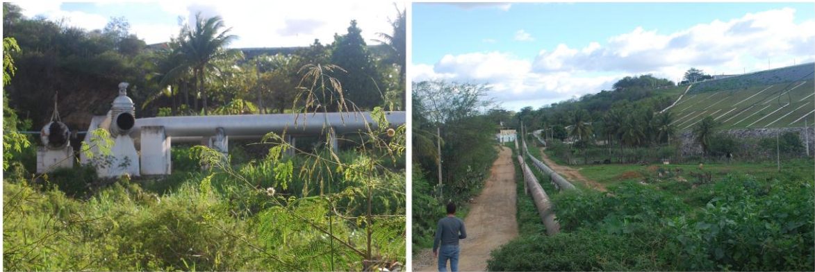
Fotografia 2 - Canalizações do sistema adutor de Boqueirão (Boqueirão/PB).
