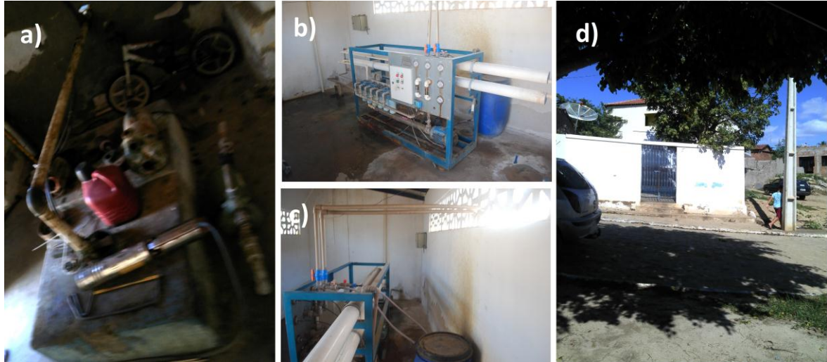
Figura 11 - a) Poço que retira água a ser tratada pelo dessalinizador. b) Estrutura do dessalinizador. c) Canalização que transporta água já tratada para o reservatório. d) Local onde se encontra o reservatório a qual a população vai buscar água.
