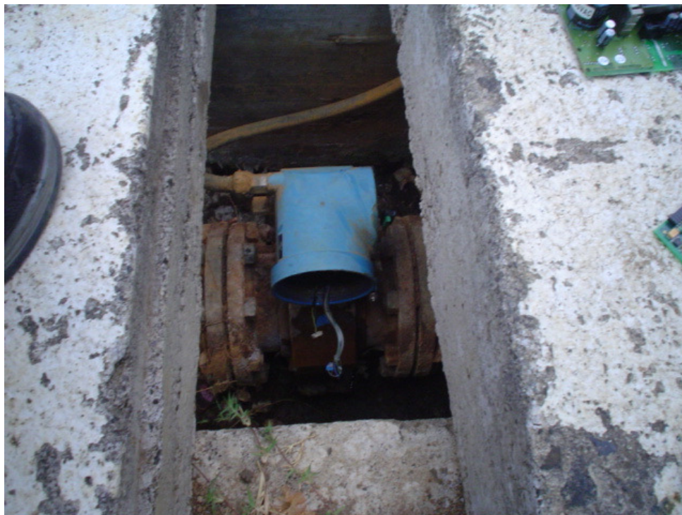
Figura 9.- Daños en medidor de gasto
