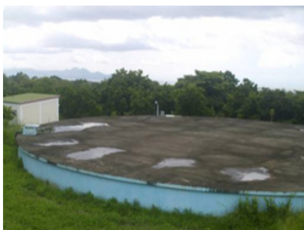
Figura 7: Tanque de almacenamiento
