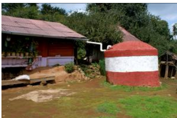
Figura 3. Sistema de captación de agua de lluvia.
