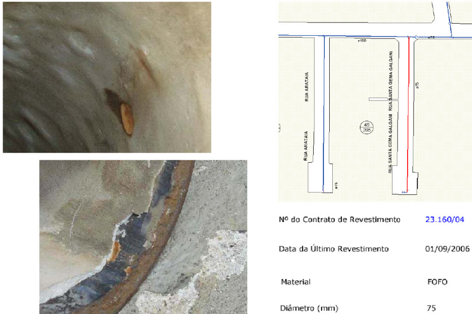
Figura 3. Amostra de tubulação de ferro fundido revestida com argamasa acrílica, 2006.
