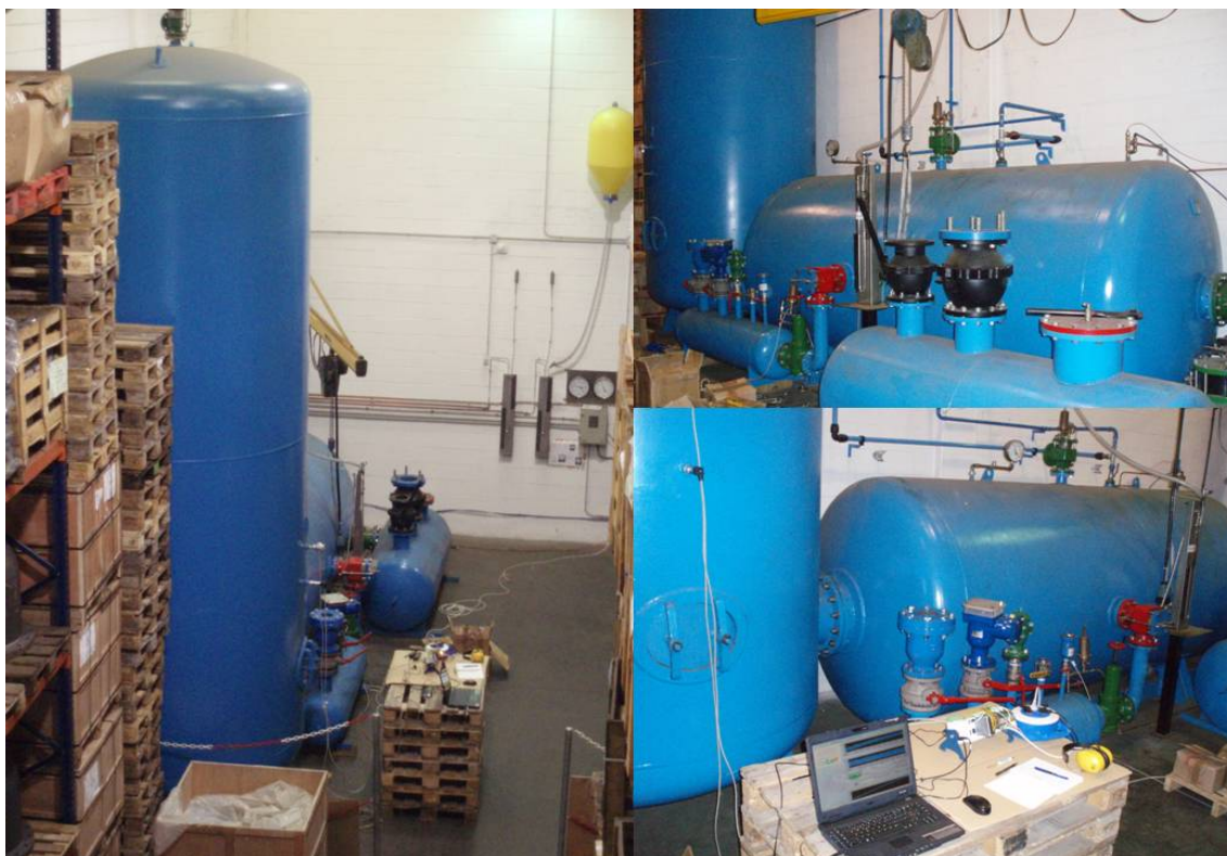
Figura 6. Instalación de ensayo de ventosas.
