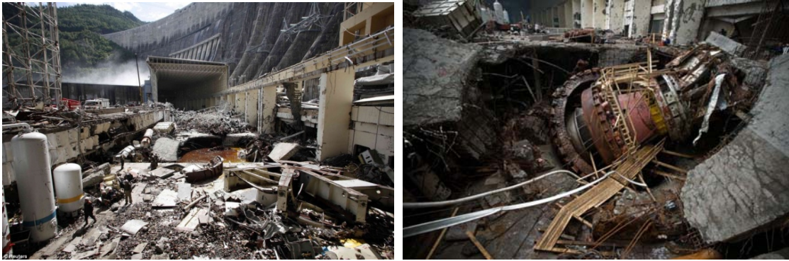
Figura 15 – Imagens da central Sayano-Shushenskaya após o acidente provocado por um regime transitório.
