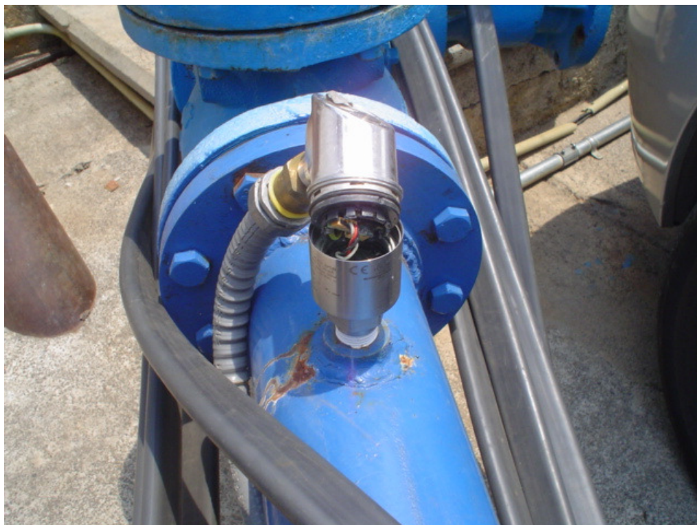
Figura 10.- Daños en sensores de presión
