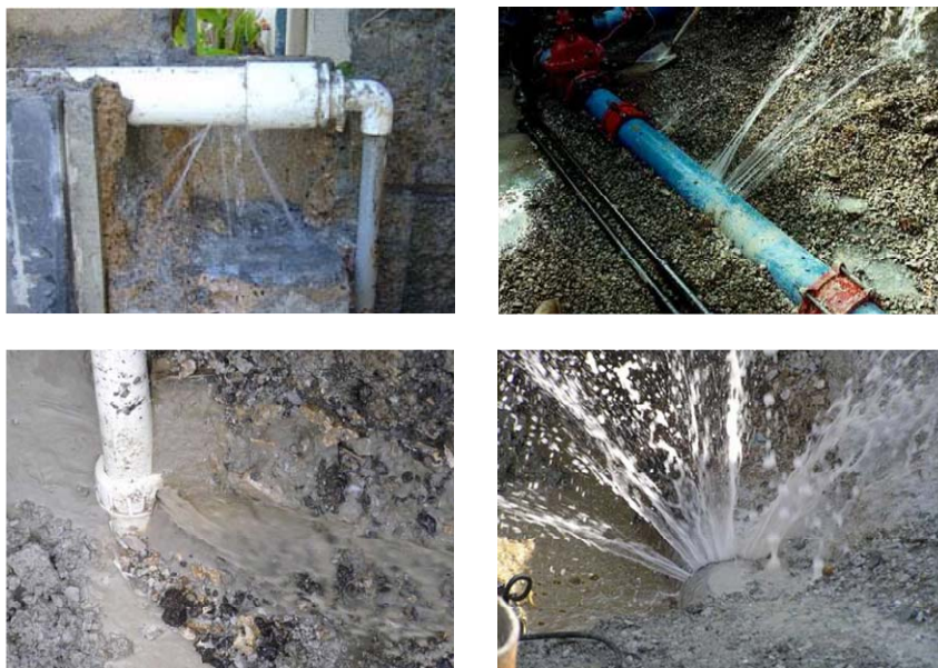
Figura 3. La presencia de fugas en las redes
