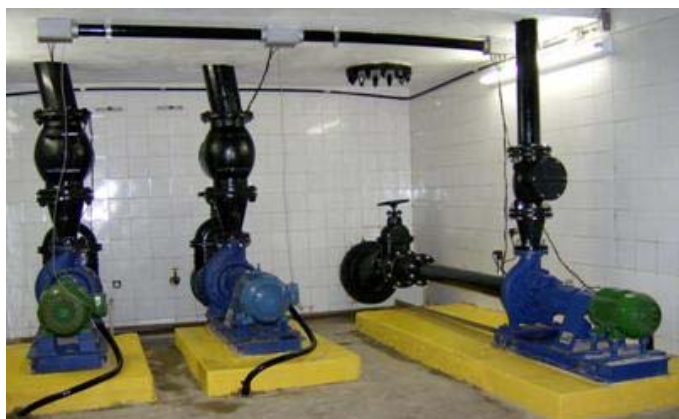
Figura 2 - Sistema de bombeamento do SADA
