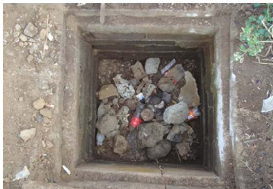
Caja de válvulas antes del mantenimiento
