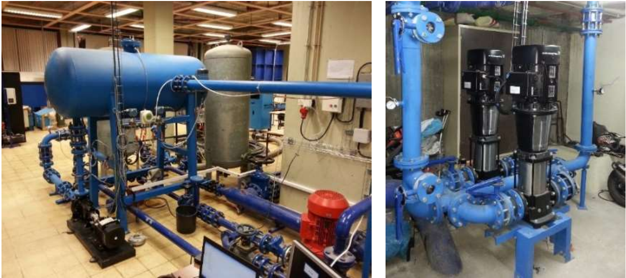
Figura 1. Instalação experimental: (a) nível superior onde está instalada a bomba a funcionar como turbina; (b) nível inferior onde estão instaladas as bombas pressurizadoras do sistema.
