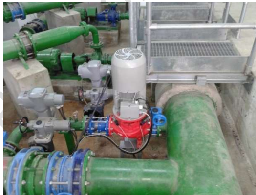
Figura 5. Imagen de la microturbina instalada en el depósito de la Coma
