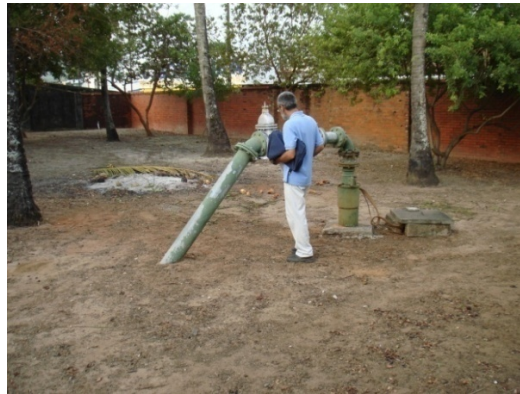
Figura 1 – Poço artesiano abastecendo diretamente um reservatório apoiado(Sistema R6 – João Pessoa)
