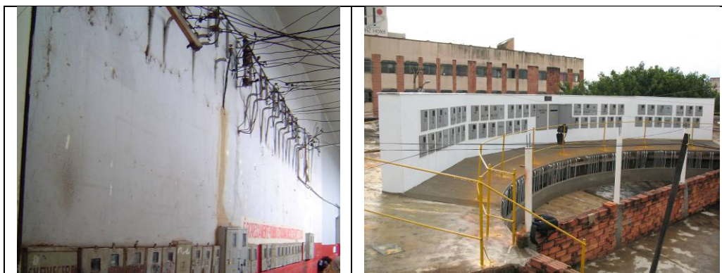
Figuras 6 e 7 - Quadros de distribuição e medição antigo e novo
