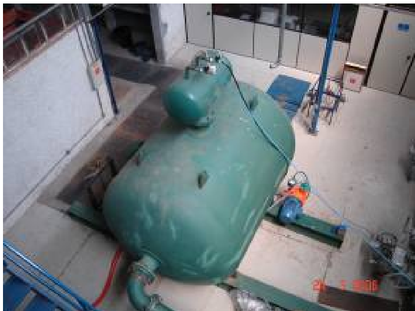
Figura 5 – Tanque fechado e bomba a vácuo para controle da pressão
