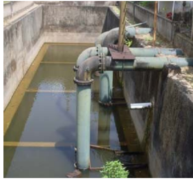
Figura 5 - Poço de sucção para água bruta abastecido por gravidade.
