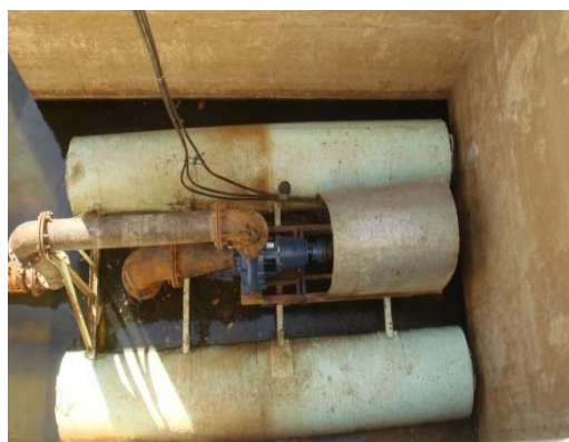
Figura 4 - Captação flutuante, bomba não afogada
