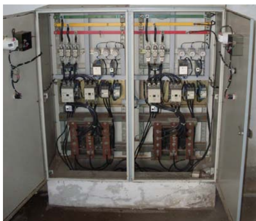
Figura 12 – Quadro de comando do sistema de bombeamento de Mamanguape
