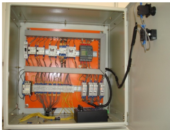
Figura 11: CLP do sistema Usina II – João Pessoa
