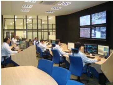
Figura 1. Centro de controle operacional (CCO) com sistema SCADA
