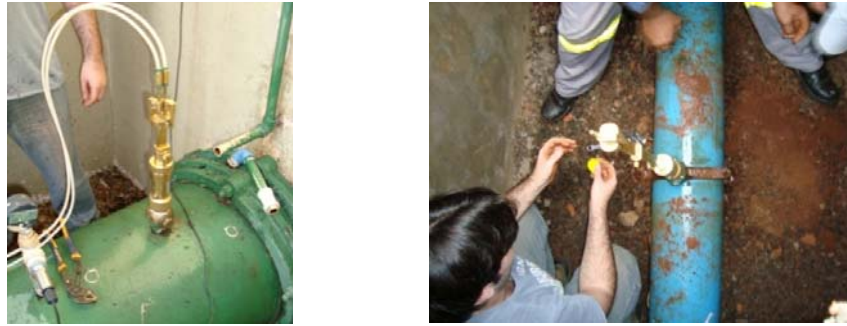
Figura 3. Instalação do tubo de pitot e determinação de diâmetro interno.
