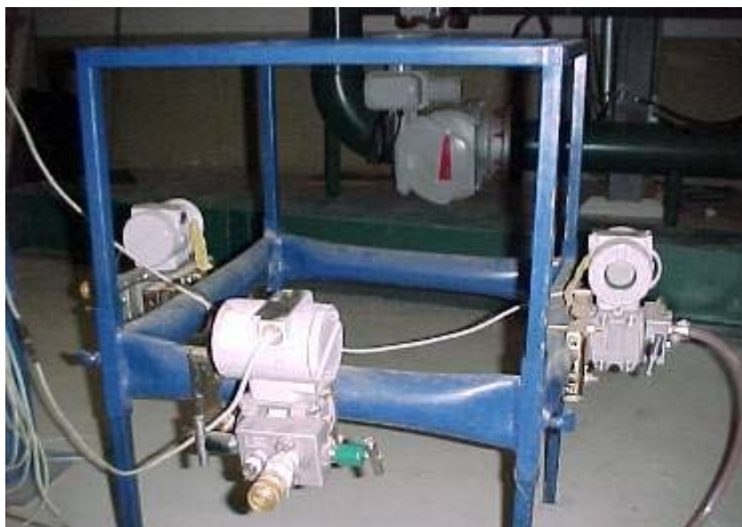
Figura 3 – Transmissores de pressão para medidas na entrada e saída da bomba
