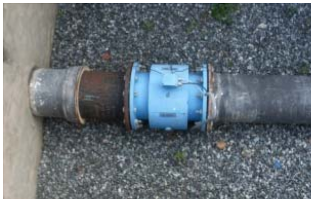
Figura 10 – Medidor de vazão eletromagnético da ETA de Sapé
