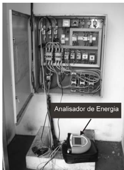
Figura 25. Analisador de energia instalado no quadro elétrico do conjunto motor bomba do setor piloto
