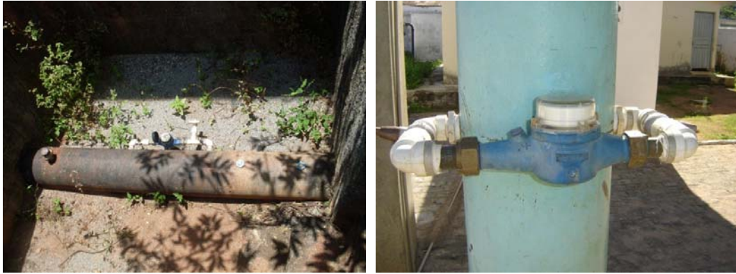
Figura 8 – Medidores de vazão proporcional
