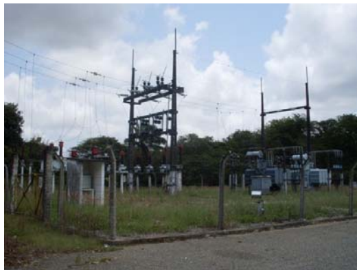
Figura 6 - Subestação que alimenta o sistema de bombeamento e a ETA Gramame
