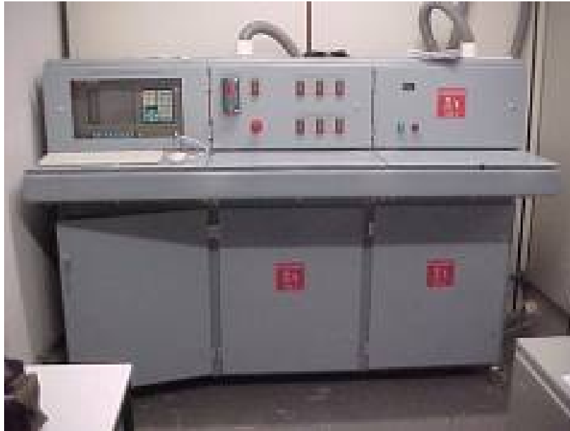
Figura 4 – Quadro de comando e proteção
