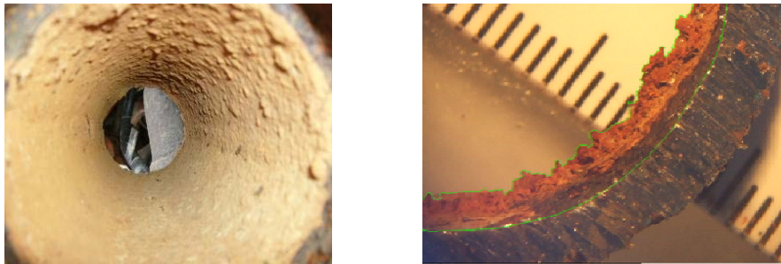
Figura 02 - Cambio de las condiciones físicas internas de una tubería con su uso
