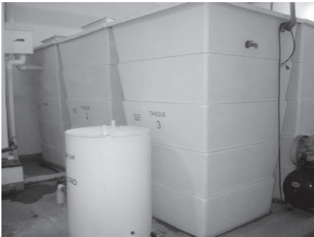
Figura 2.38 Estação de tratamento de águas cinza (ETAC)
