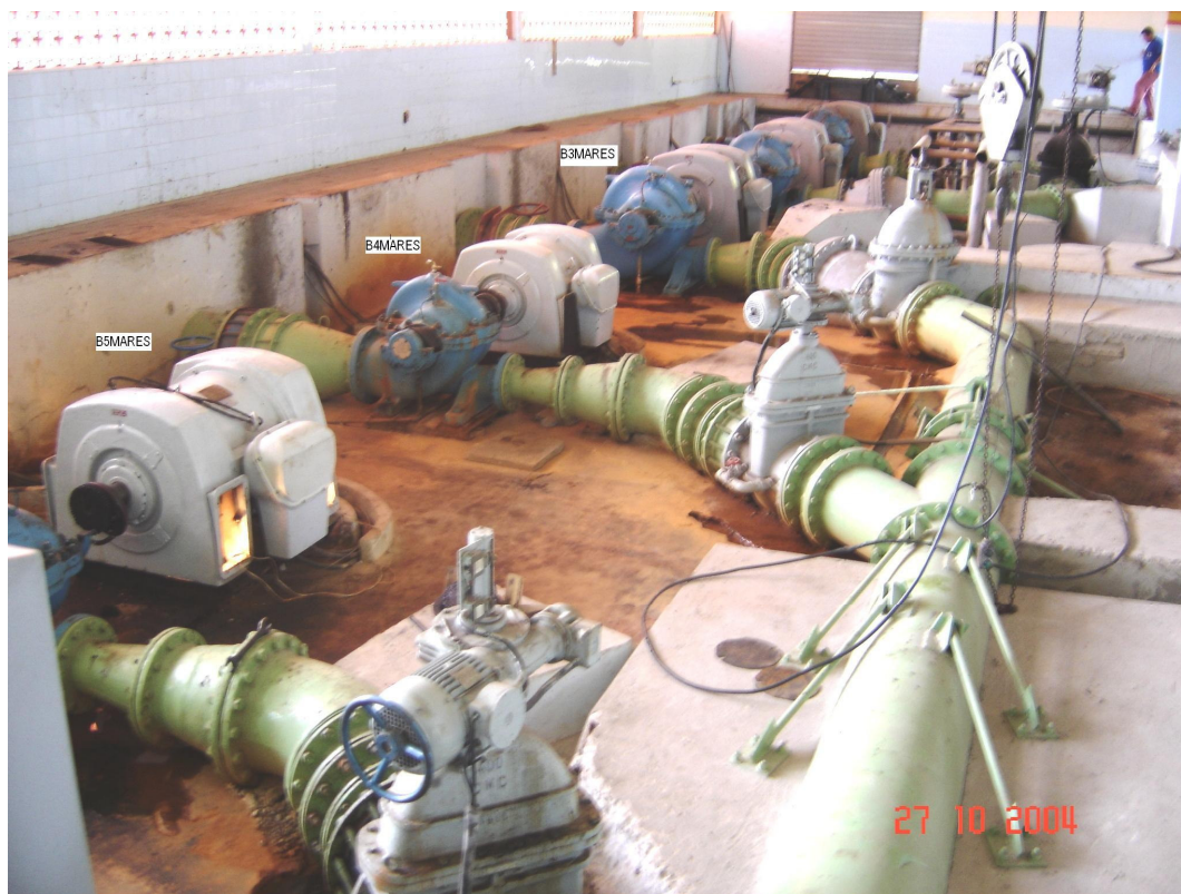
Figura 5.3 – Vista interior da elevatória Marés.
