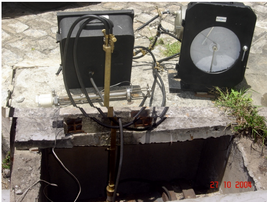
Figura 5.24 – Registrador de pressão e vazão no TAP.
