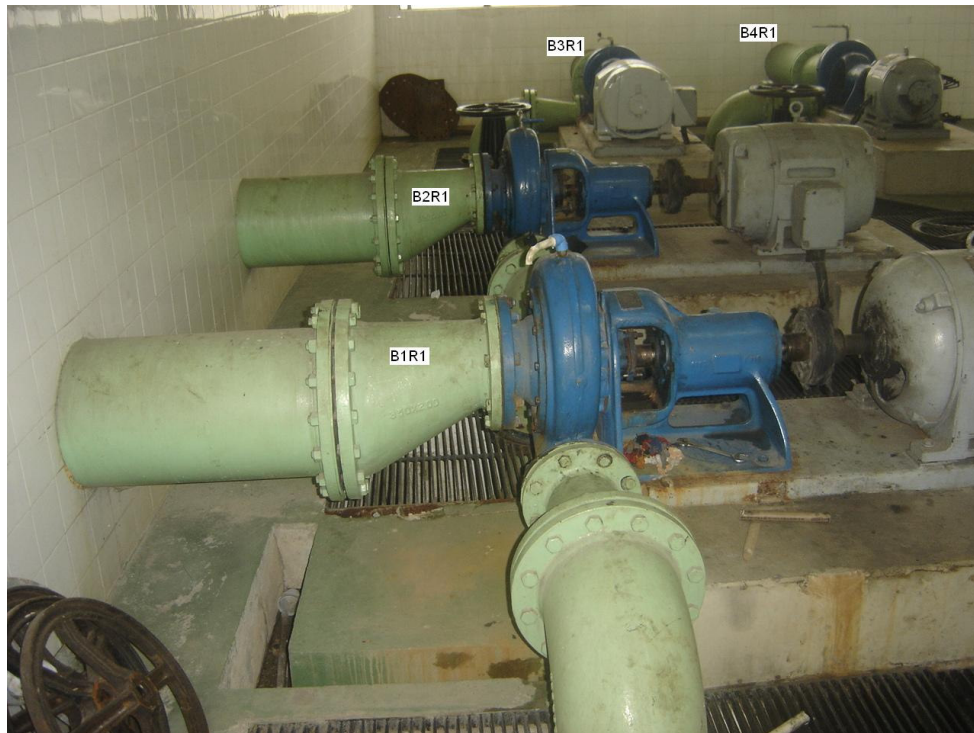
Figura 5.5 – Elevatória do Centro de Distribuição, R1.
