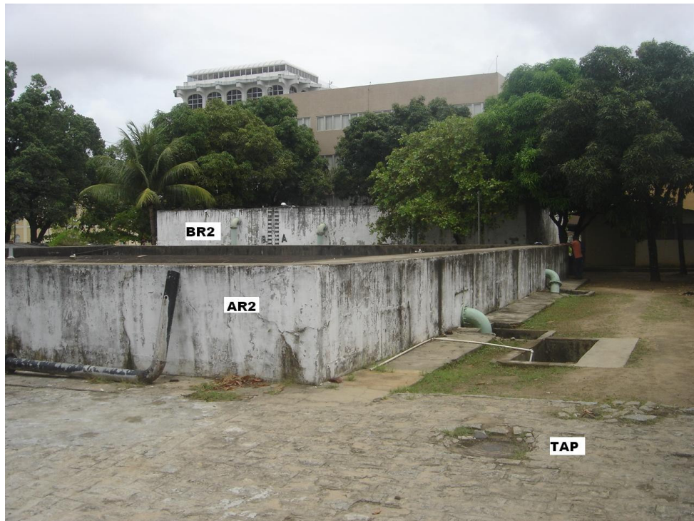
Figura 5.8 – Vista do sistema de reservação e distribuição R2.
