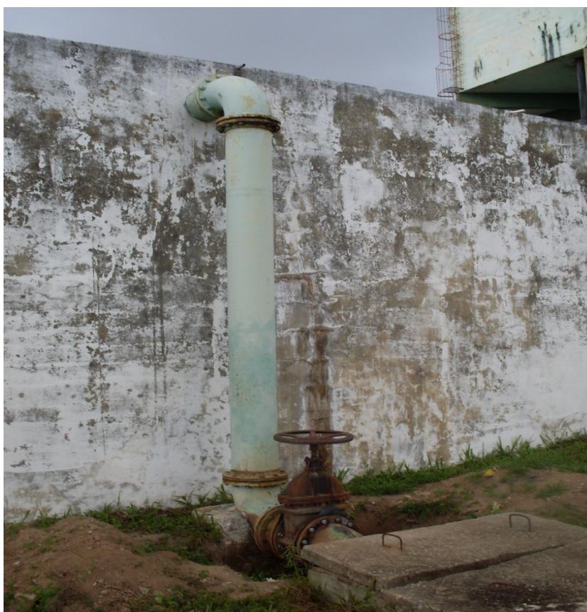
Figura 3.4 - Tubulação de chegada no Reservatório Apoiado R-7
