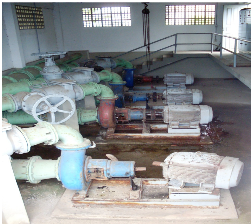
Figura 3.7 - Estação Elevatória "B"
