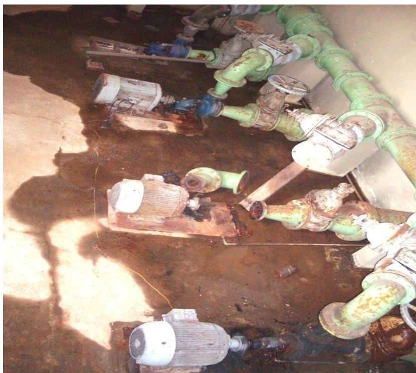
Figura 3.6 - Estação Elevatória “A”
