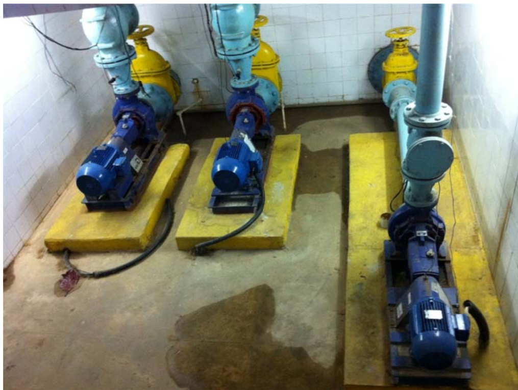
Figura 3.8 - Conjuntos motor-bomba do LENHS UFPB
