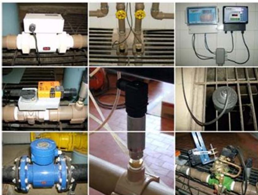
Figura 3.7 - Equipamentos diversos existentes no SPDA
