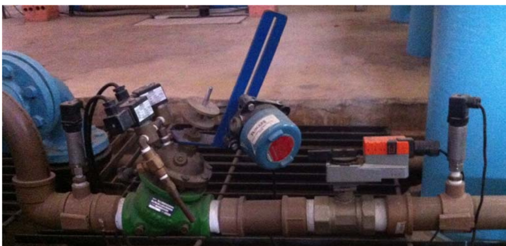
Figura 4.12 - Válvulas Instaladas do SPDA do LENHS
