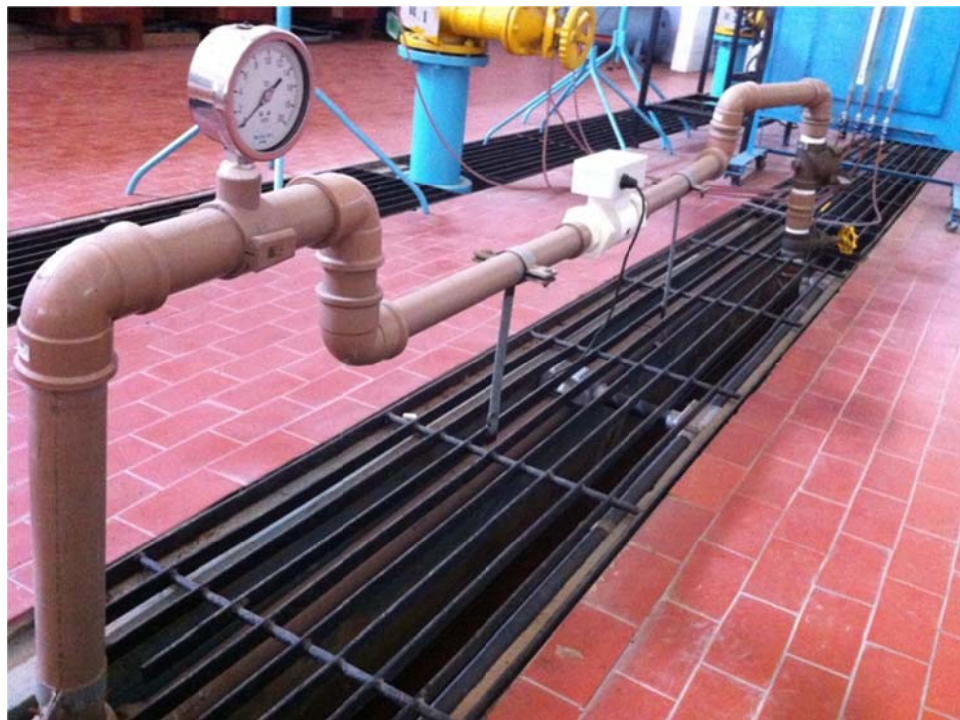
Figura 3.10 - Manômetro instalado e identificado em uma das saídas do SPDA
