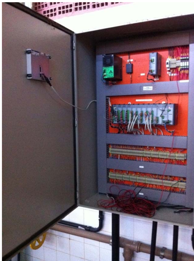
Figura 3.9 - Controlador Lógico Programável – CLP
