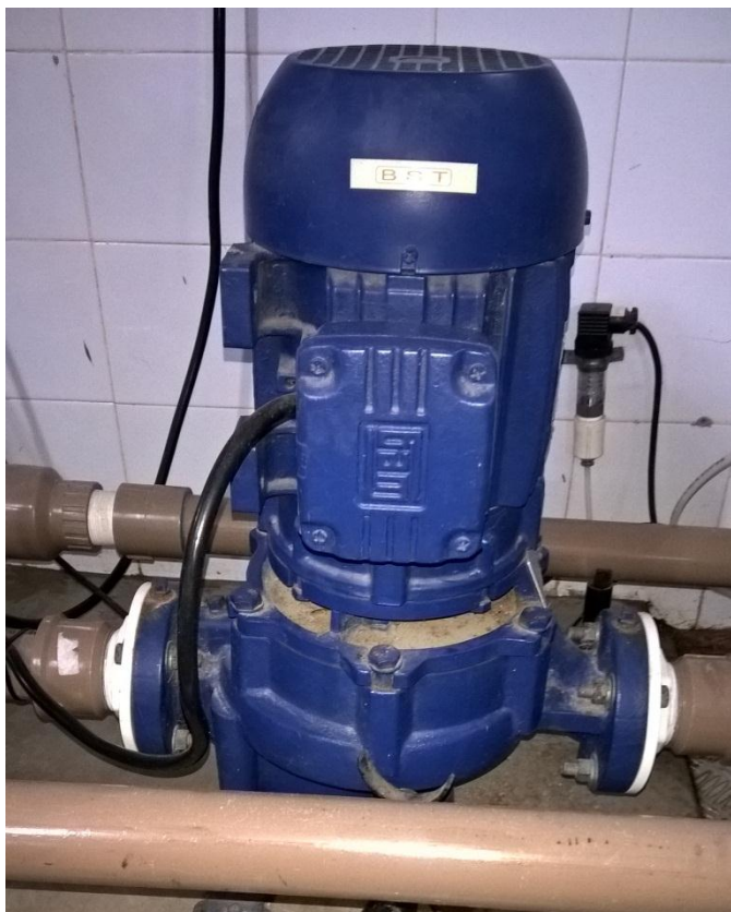
Figura 4.3 - Sistema de Elevação booster
