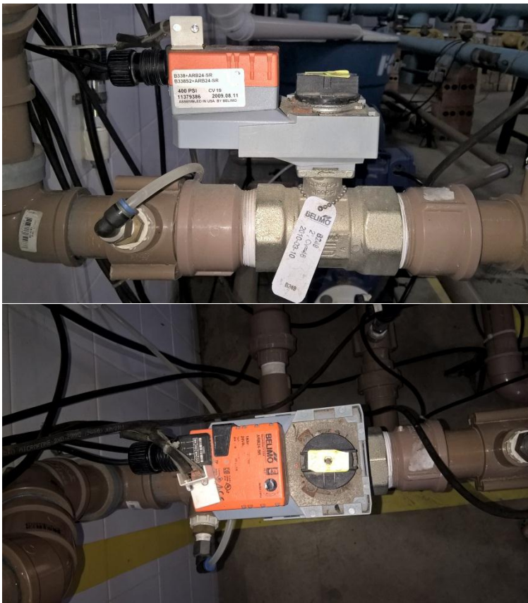
Figura 4.6 - Válvula Redutora de Pressão
