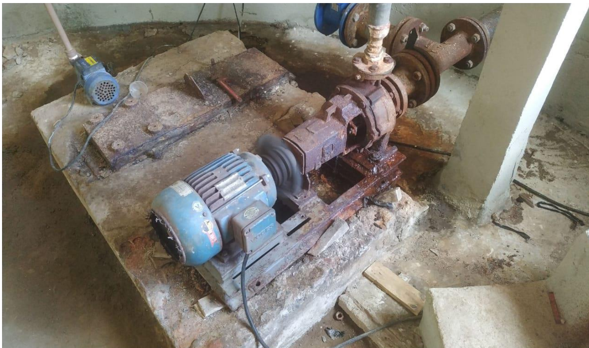
Figura 4.7 – Conjunto motobomba de 5 cv da EEAT3.
